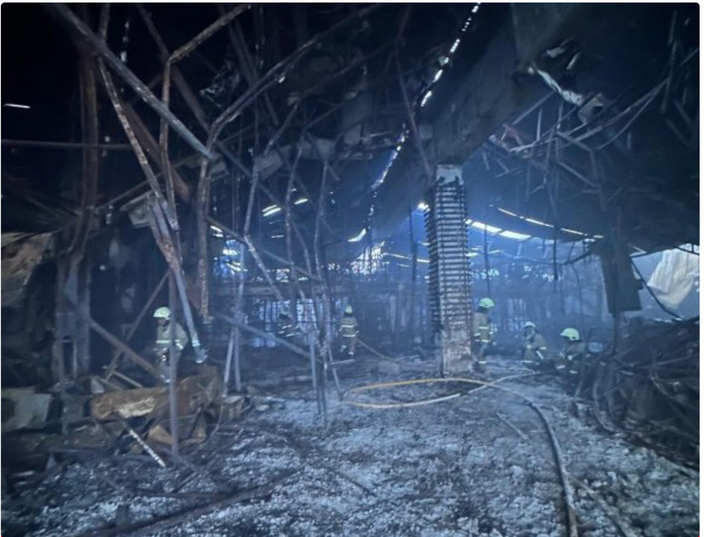
Glodok Plaza yang Hangus Terbakar
